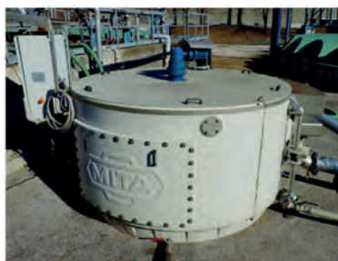
Fig. 5.1. Impianto pilota filtrante MITA.
