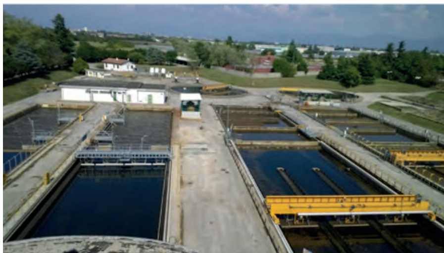
Fig. 4.1. Impianto di depurazione di Udine (Friuli Venezia Giulia).
